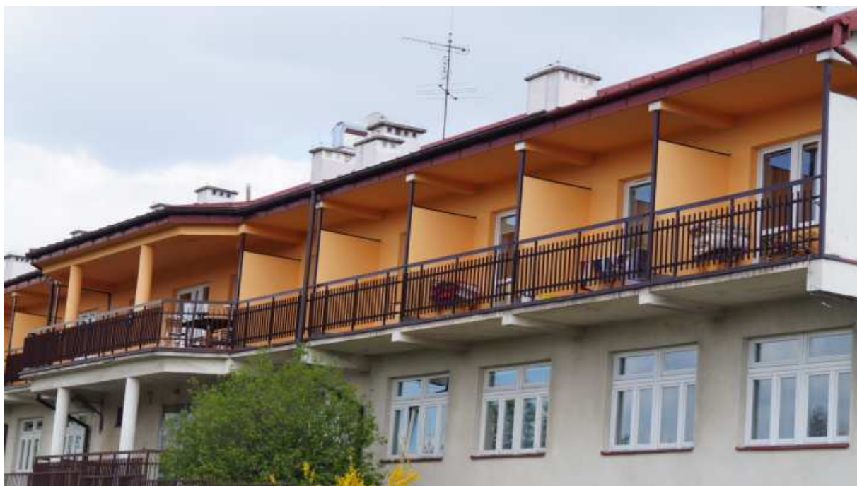
Fot. 4. Widok stanu warstwy zewnętrznej tynku.
