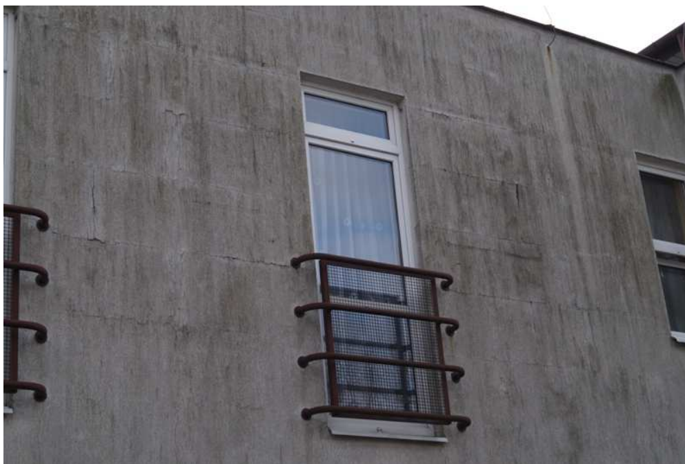
Fot. 4. Widok stanu warstwy zewnętrznej tynku.
